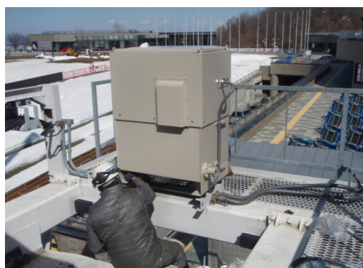
緊張装置油圧ユニット更新
